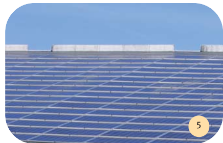
Faîtière ouverte avec tôles pare-vent interrompues.
