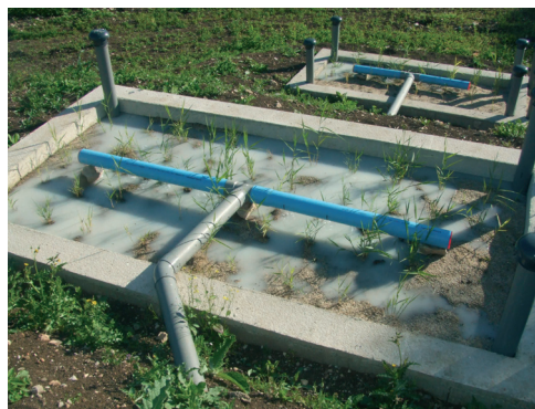
Filtre planté de roseaux - quelques semaines après mise en service
